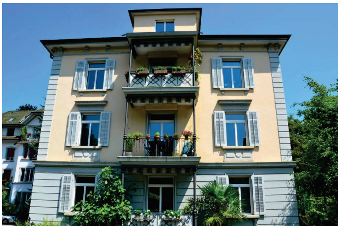
Das schützenswerte Objekt erstrahlt nach dem Einbau der neuen Fenster in neuem Glanz.
