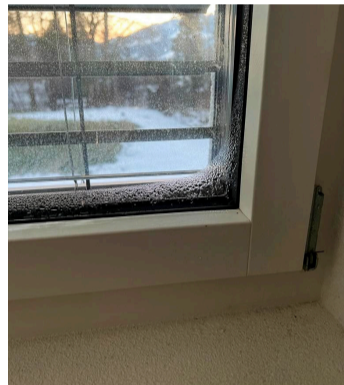
Kondensatbildung an älteren Fenster aufgrund geringer Wärmedämmung.
